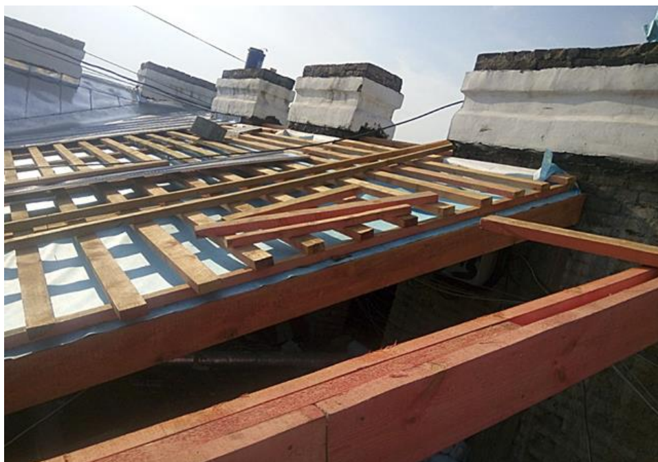
Рис. 2. Стропила из сосновых досок выполнены при реконструкции исторического здания в Санкт-Петербурге. Фото Д.А. Животова, 2020 г.
