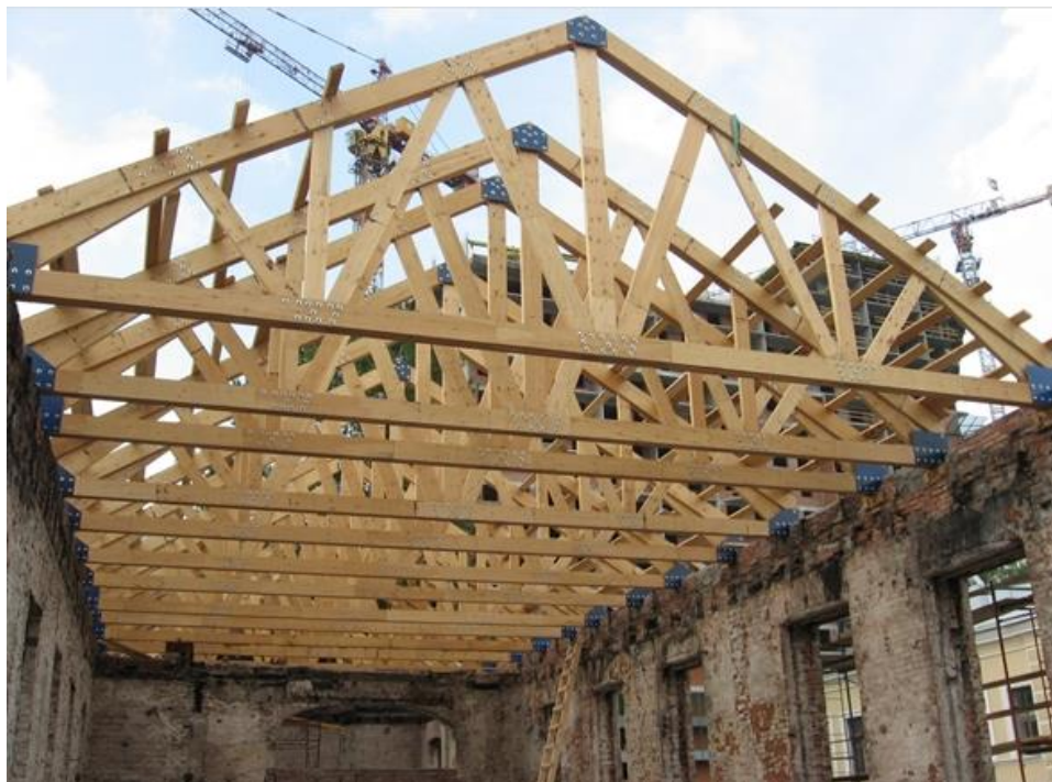
Рис. 7. Реконструкция стропильной системы корпуса Военно-медицинской академии после пожара (г. Санкт-Петербург, ул. Лебедева, 4). Фермы из LVL бруса Источник: https://lvibrus.ru/fotogallereya/rekonstrukciya_krovli_vma/ (дата обращения: 29.07.2023)
