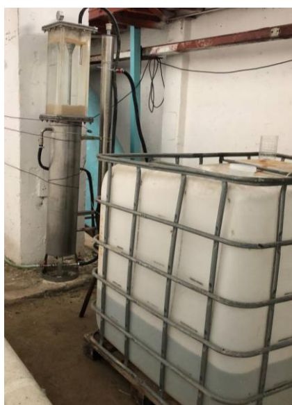
Рис. 3. Установка по исследованию очистки промывных вод фильтров на НФС-1, г. Новосибирск (слева – модель напорного реактора-осветлителя (Р/О), справа – отстойник отработанной промывной воды фильтров)
