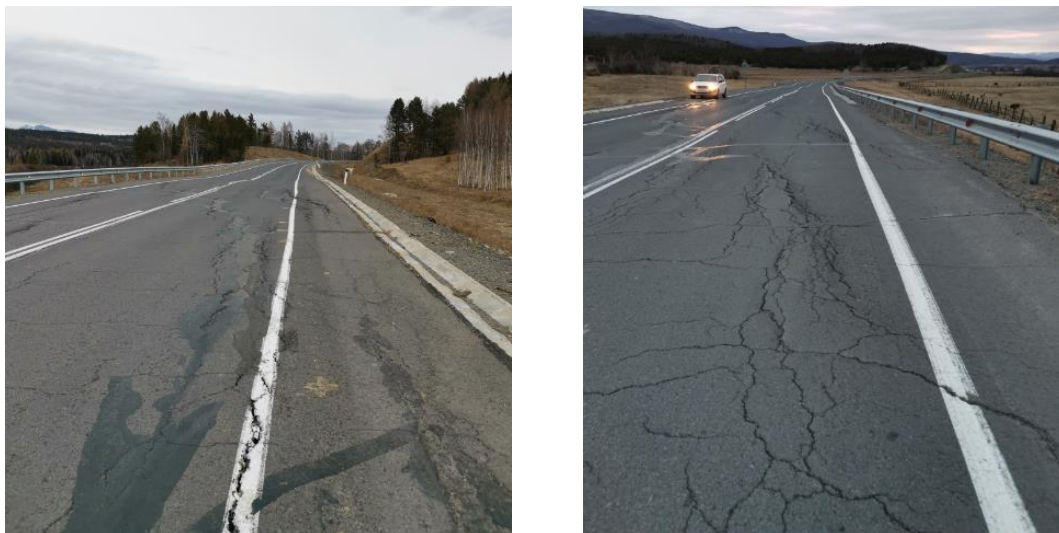
Рис. 2. Деформации участка автомобильной дороги
